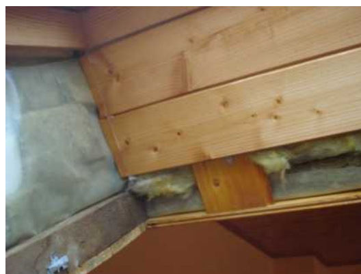
Netěsné napojení parotěsné vrstvy na střešní okno
